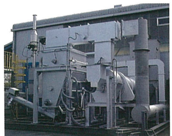
高水分原料炭化プラント
