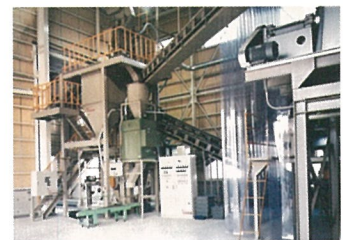
育苗床土生産プラント
